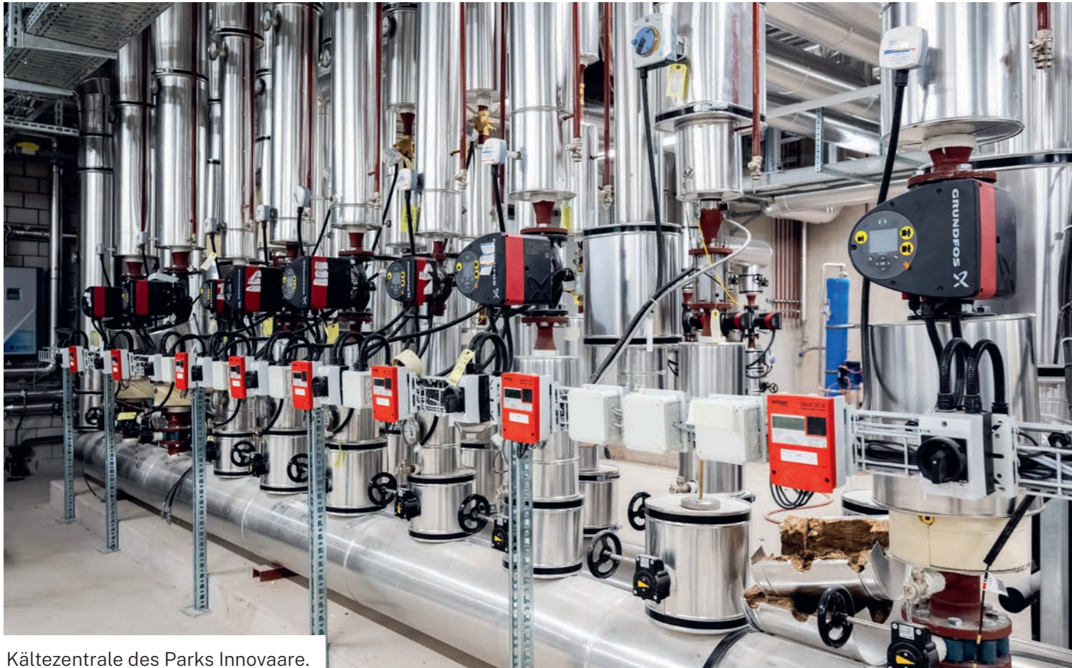
Kältezentrale des Parks Innovaare.
