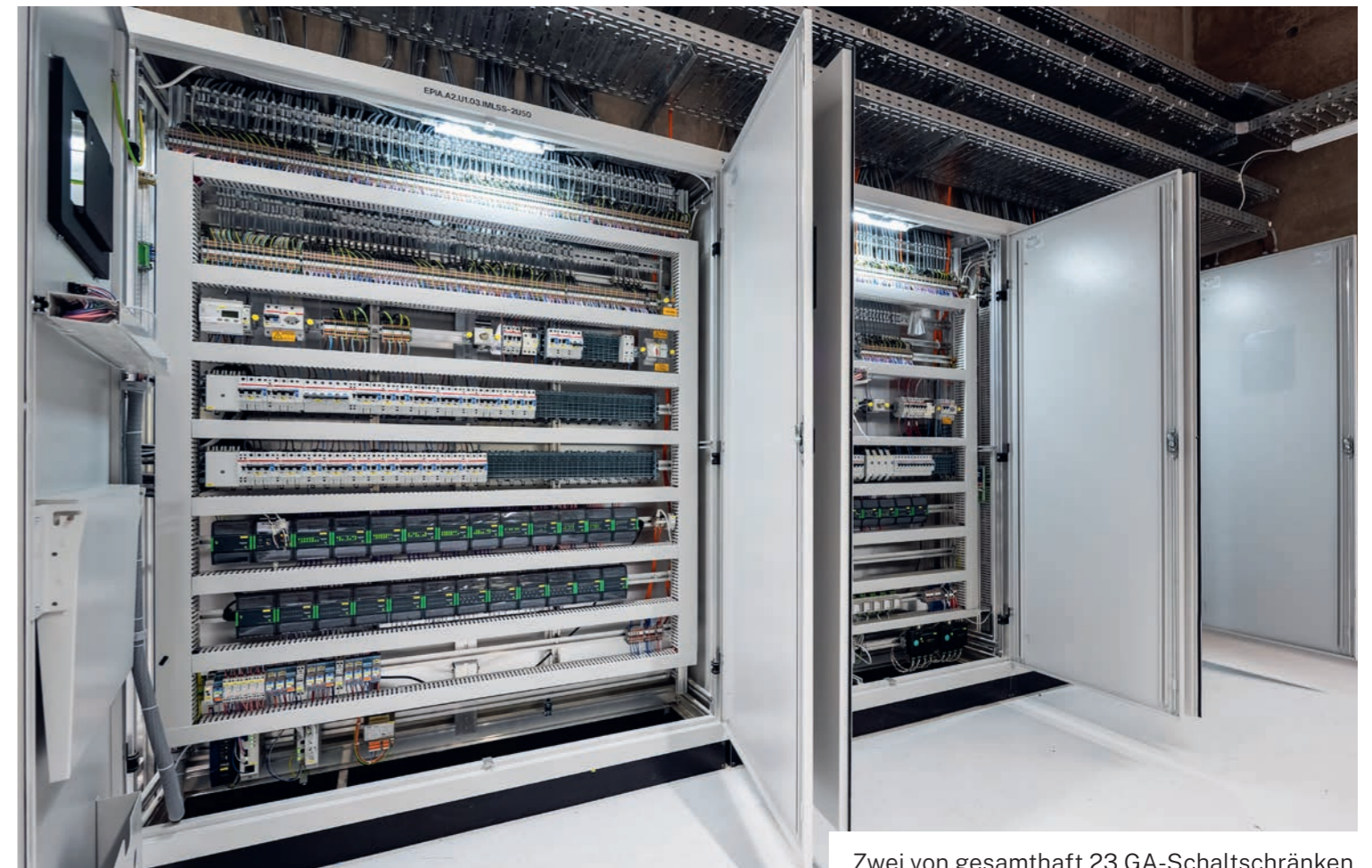
Zwei von gesamthaft 23 GA-Schaltschränken.
