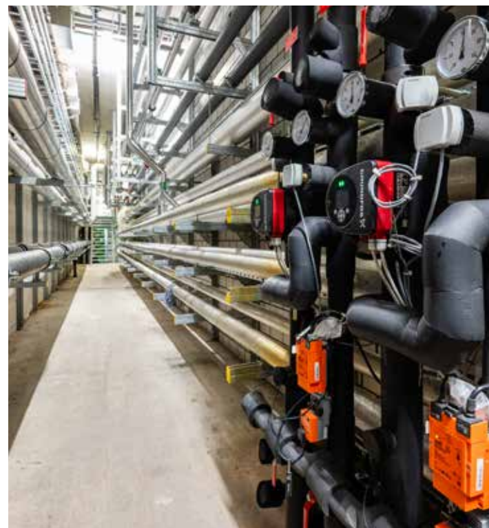
Die Kälteverteilung in der Betriebszentrale wird von A bis Z von der Burkhalter- GA orchestriert.
