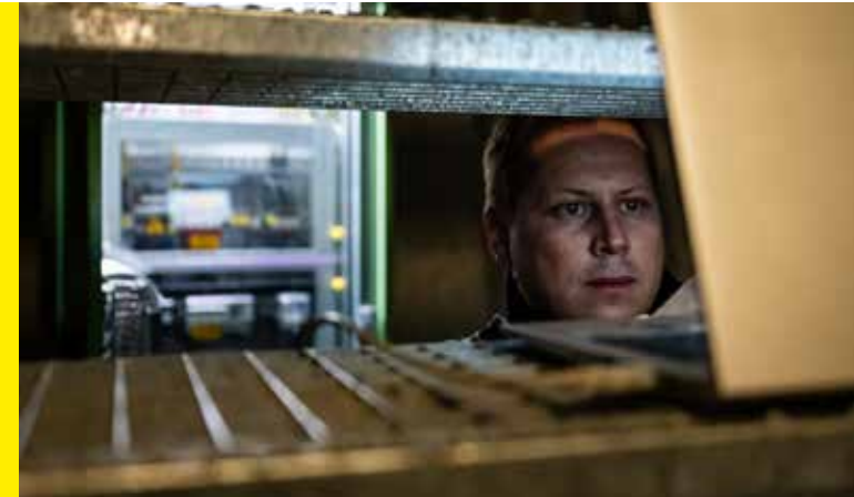
Projektleiter Fabio Lehmann spielt vor Ort ein Update für die Steuerung der Kühlung ein.
