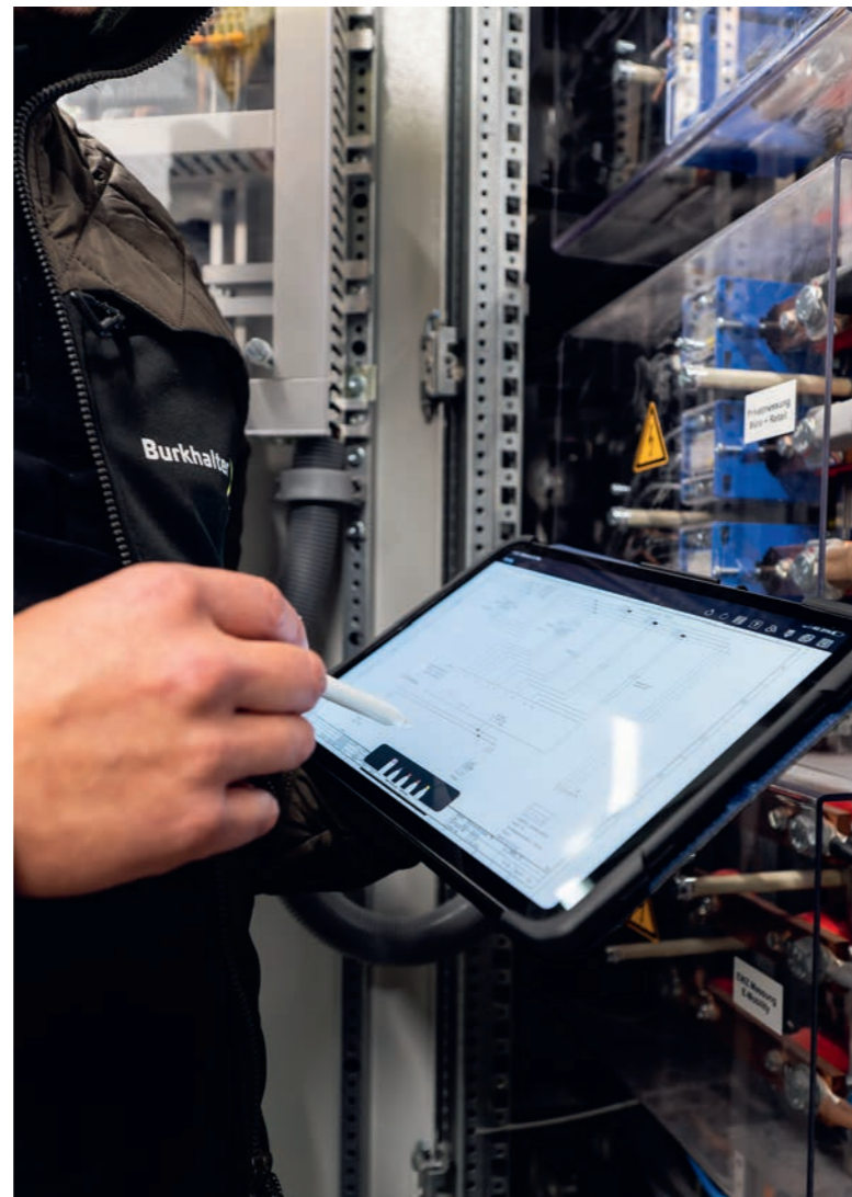
Die neuerstellte Niederspannungs-Hauptverteilung liefert Stark- und Schwachstrom.
