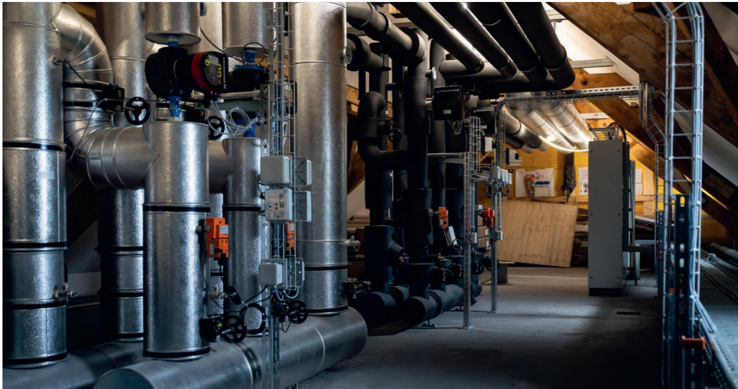
Direkt unter den Holzsparren der Dachkonstruktion ist eine Lüftungszentrale praktisch fertig installiert.
